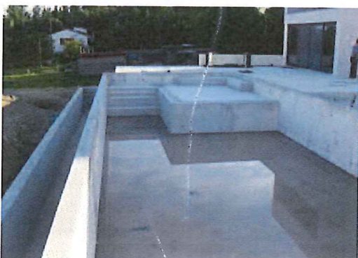
Piscine débordement ou cascade avec bac tampon.
